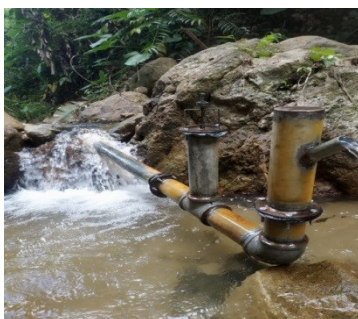
Gambar 3.1 Posisi Pompa PATM yang terinstalasi pada lokasi pengujian.
