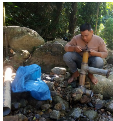
Gambar 2.2 Instalasi Pompa Air Tanpa Mesin pada Lokasi Pengujian
